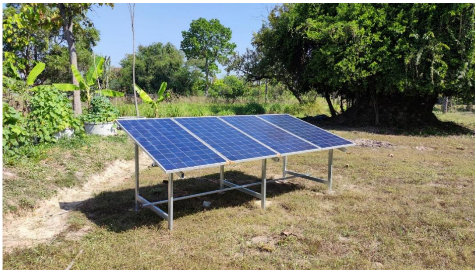
รูปที่ 21 การติดตั้งแผงโซลาร์เซลล์เพื่อใช้กับระบบผลิตไฟฟ้าพลังงานแสงอาทิตย์แบบออนกริดเพื่อลดค่าไฟฟ้า ในกระบวนการผลิตผ้าย้อมคราม
